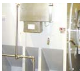
Dispositivo de presurización
